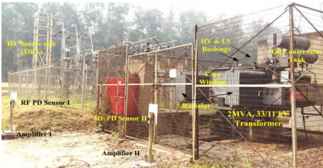
Тестовая установка на подстанции
